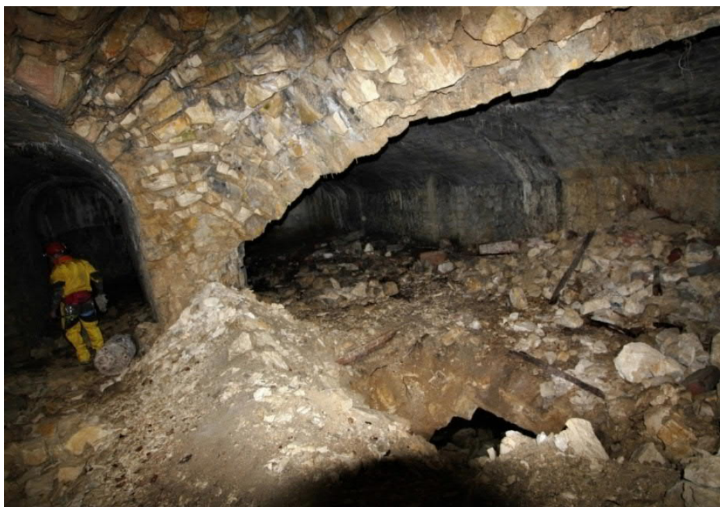
Fig. 1 : Chambrées mitoyennes dans une partie non modernisée d'un fort de Verdun. Les voûtes ont été perforées et leurs pieds-droits pulvérisés. Le sol de la chambrée de droite a également été perforé, laissant apparaître la grande citerne située en dessous.
