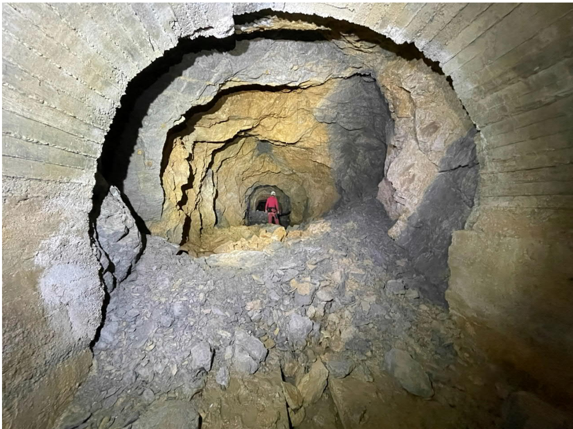
Fig. 1 : Après la fin de la galerie maçonnée, un éboulement a créé un barrage de 0.8 m de haut qui retient l'eau de ruissellement.
